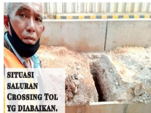
Gambar IV.10 Keadaan Saluran Crossing Tol yang diabaikan
